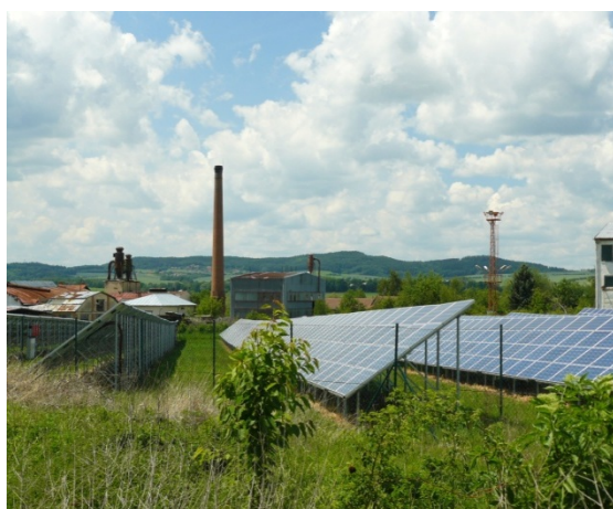
Obr. 9 Fotovoltaická elektrárna Šebetov
