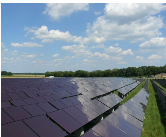
Obr. 5 Fotovoltaická elektrárna Hrádek
